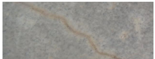
ひび割れ閉塞(拡大写真)
